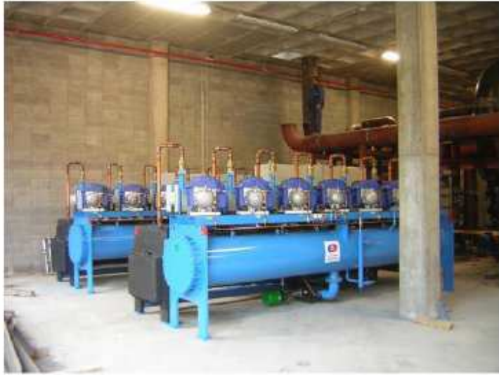
Figura 22: Unidades emplazadas en sala de máquinas final
